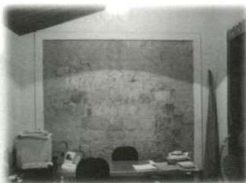
Figura 5: Parede original no casarão do IPHAN/Cuiabá-MT
