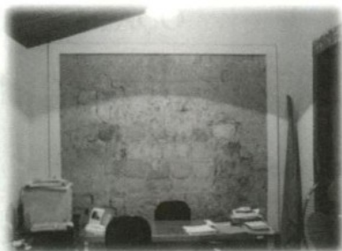
Figura 5: Parede original no casarão do IPHAN/Cuiabá-MT
