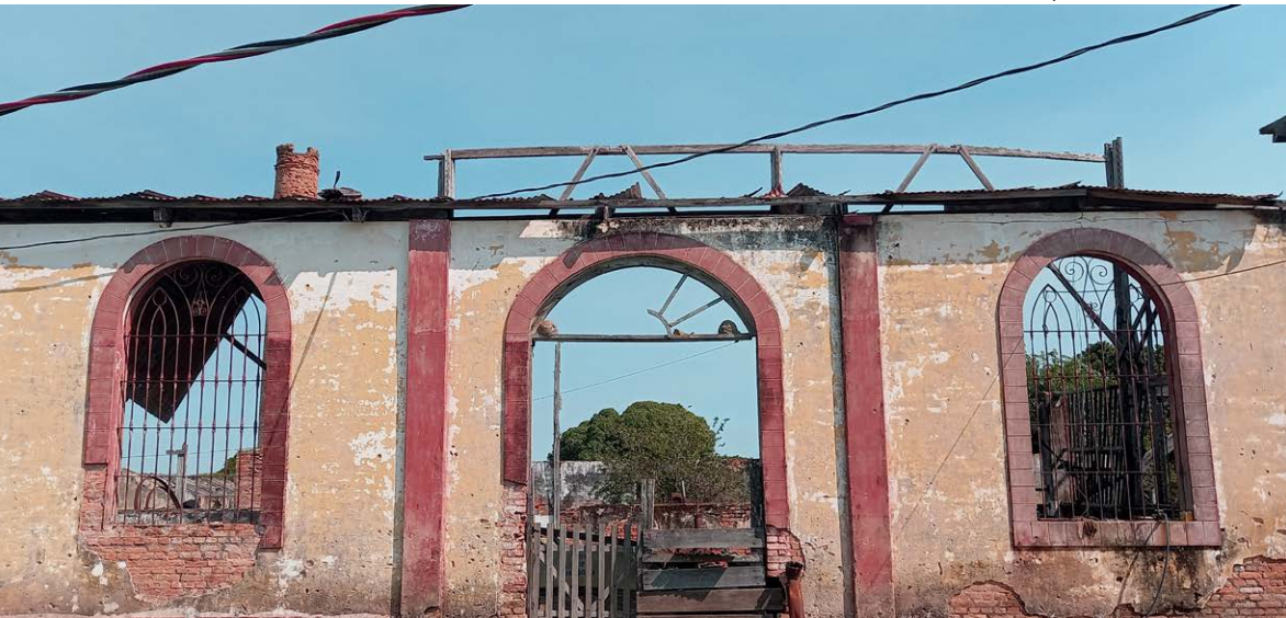
Fig. 6 – Fachada da Casa de Máquinas em Ruínas.
